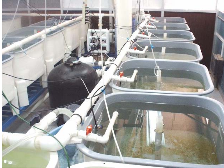
Figura 3. Sistema de circulación cerrado utilizado para la crianza de larvas de cabrilla arenera en la UPIMA del CICIMAR. La unidad de filtración consiste de un filtro de arena, un filtro biológico con lodos activados, un espumador de albúmina, una unidad de luz U.V., y una columna de aireación.
